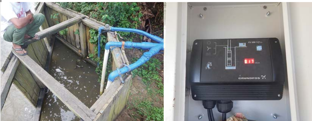
Foto instalasi air bersih dengan menggunakan energi listrik tenaga surya
